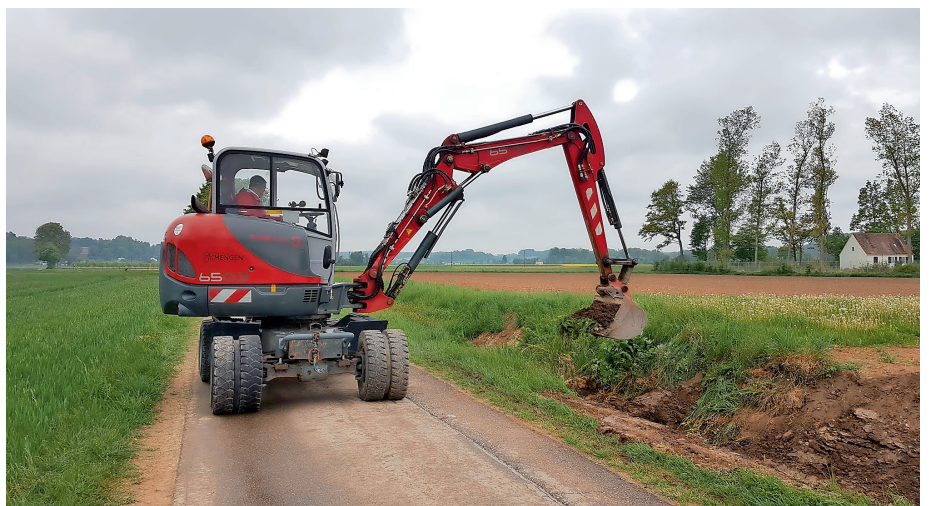
Foto: Stadt Mengen; Bürgermeister Stefan Bubeck führt den entscheidenden Baggerbiss zur Verlegung des Mittlererweggrabens durch
