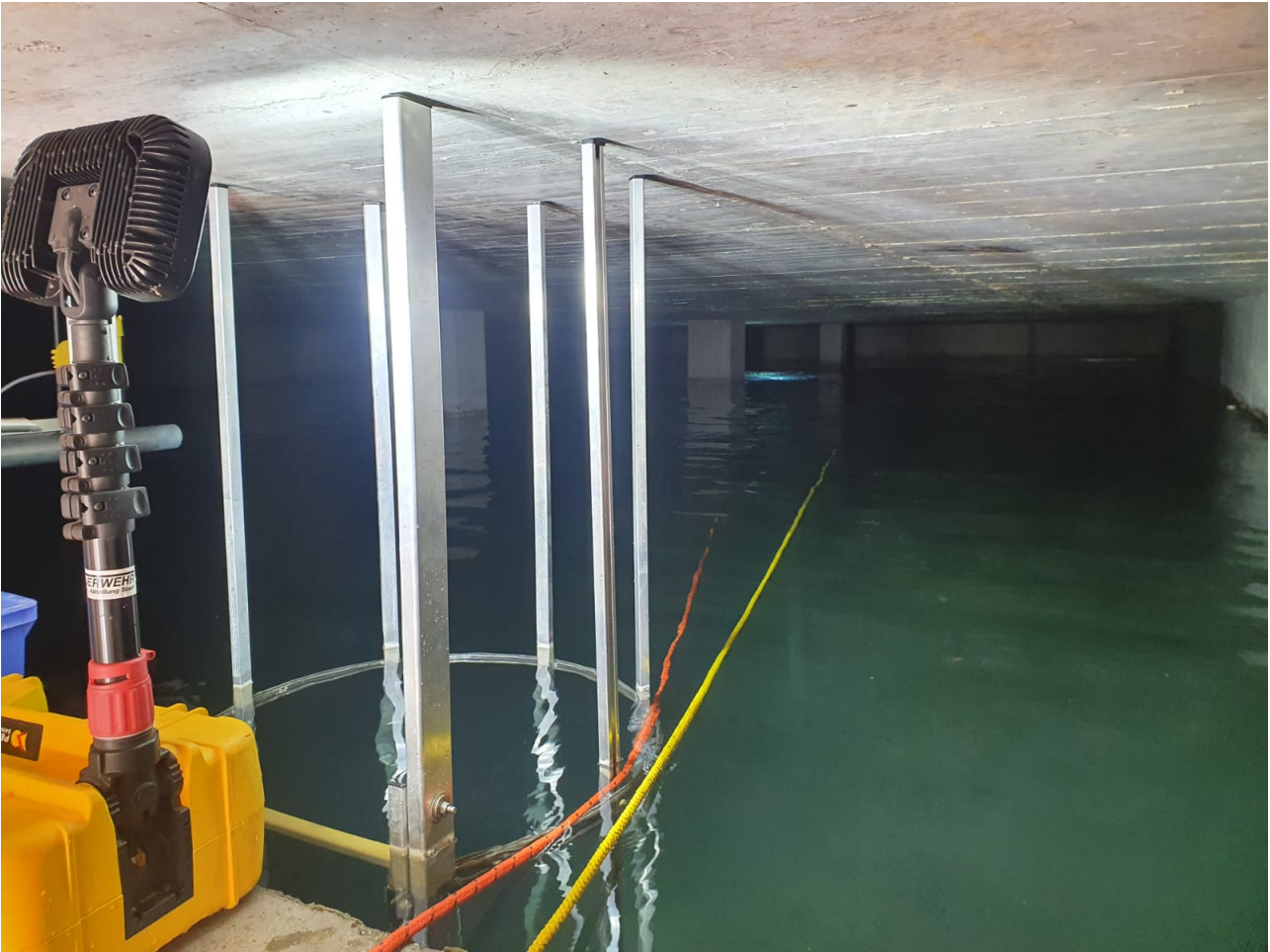
Einblick in den großen Sprinklertank
