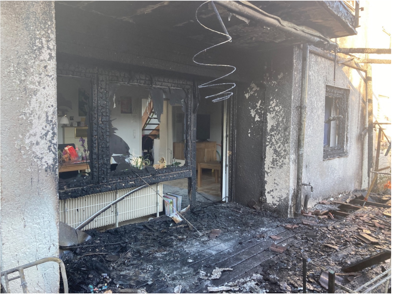
Sehr deutlich ist der Löscherfolg zu sehen | Trotz zerstörter Fenster sind die angrenzenden Wände nicht massiv mit Ruß beaufschlagt
